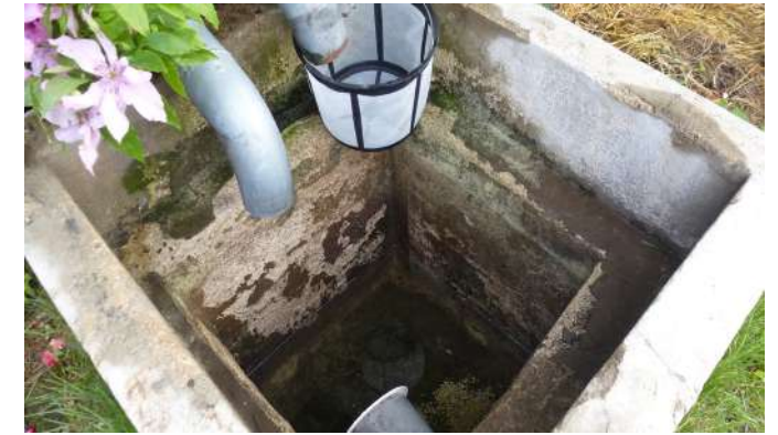
Panier dégrilleur avant entrée dans la citerne
