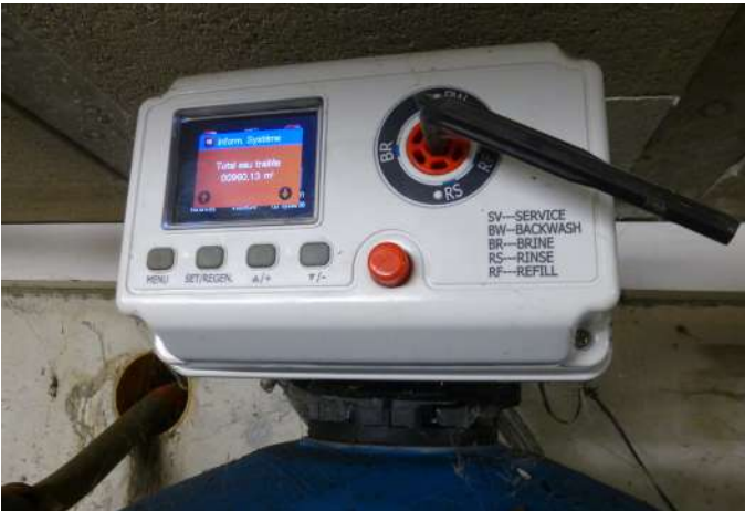
Exemple de compteur comptabilisant les eaux traitées
